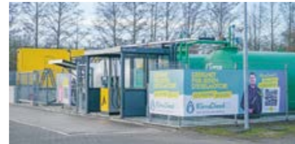
Die Tanks für KlimaDiesel25 und KlimaDiesel90 befinden sich hinter der CLASSIC Tankstelle in Hoya.
