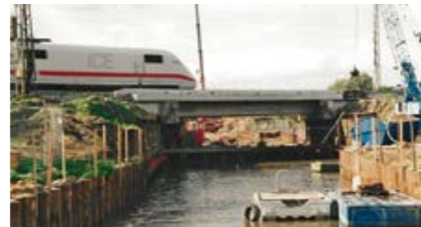
Die Unterführung im Oktober 1999. Der erste ICE überquert die neue eingeschobene Brücke über die Kreisstraße 14. Trotz der damaligen trockener Witterung sieht es hier eher nach einer Brücke über einen Kanal aus.
