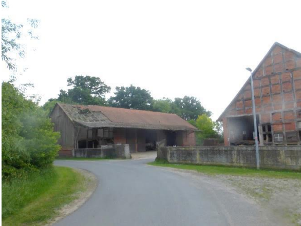
Abbildung 1: Untergenutzte ehemalige Hofstelle Wechold 45 - Gefahr des Bruchfallens der Nebengebäude
